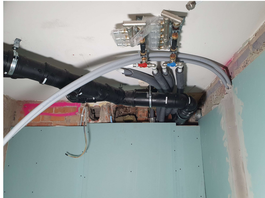
IMD, kall- och varmvatten dras från badrum via hall till kök i vit kabelkanal alt. gipstrumma i takvinkel.
